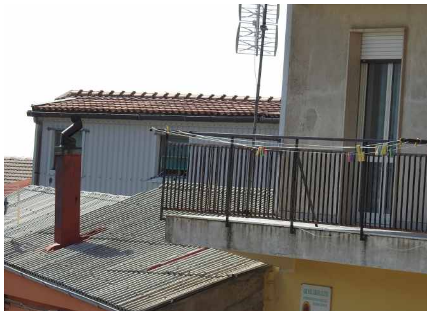
Foto N°7 - Vista della falda di copertura a contatto con il fabbricato di proprietà Burlato Mauro
