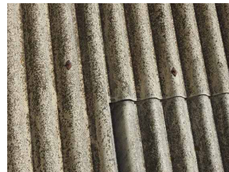
Foto N°12 - Particolare del degrado materico a carico delle lastre di copertura con segni di formazione pregressa licheni
