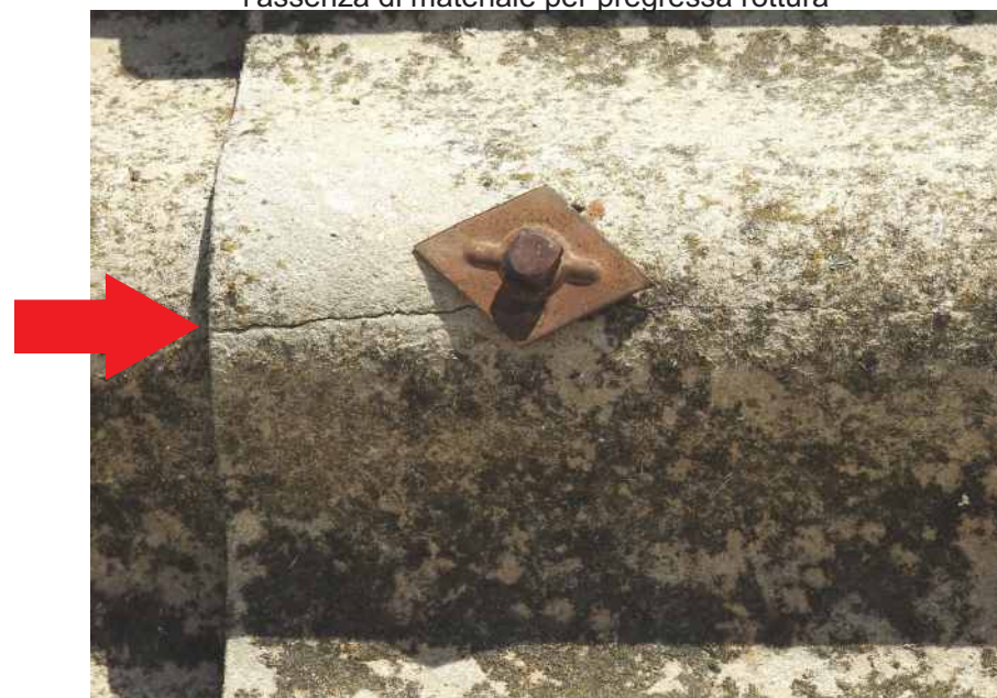
Foto N°14 - Particolare vite di fissaggio con presenza di frattura
