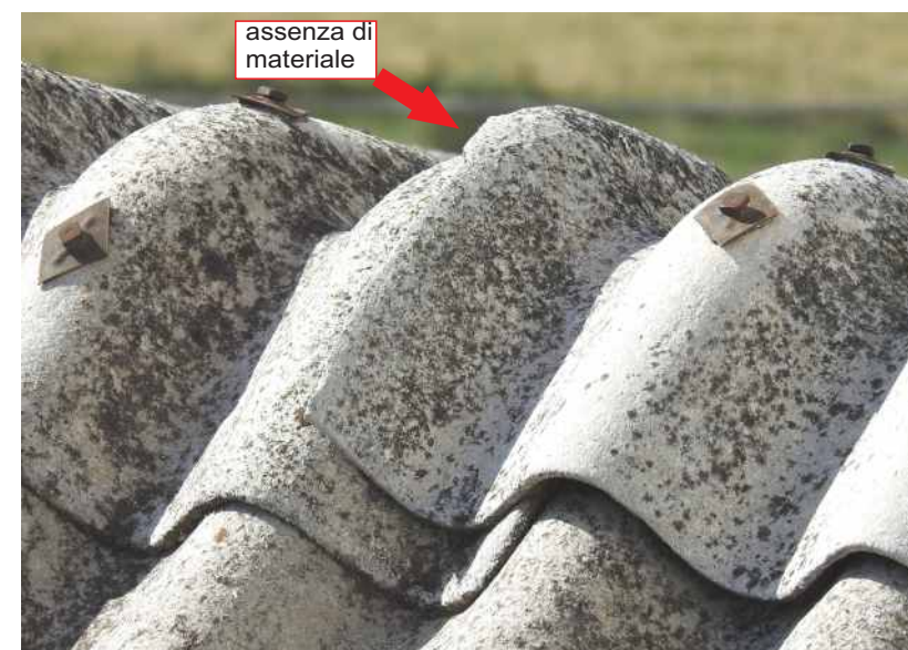
Foto N°11 - Parte del colmo ove un elemento di copertura denota l'assenza di materiale per pregressa rottura
