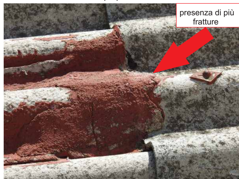
Foto N°10 - Particolare delle fratture di foto N°15
