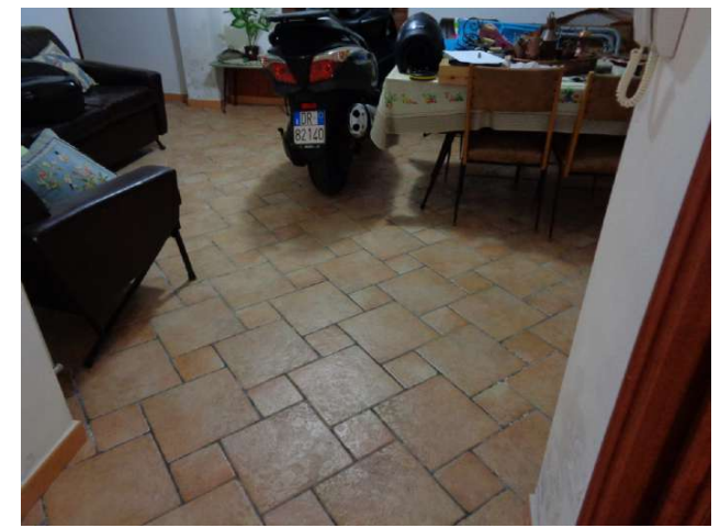
FOTO N°12: vista del pavimento nella zona soggiorno
