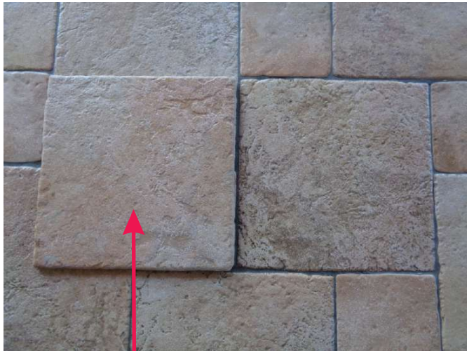
FOTO N°4: raffronto tra il campione ed una piastrella del pavimento prima del lavaggio (zona opposta all'ingresso)
