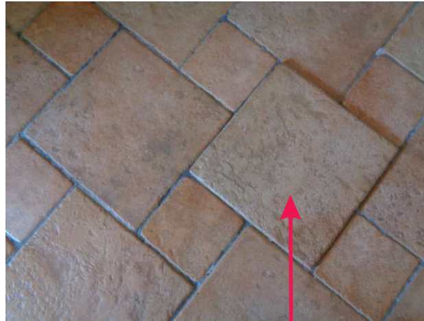
FOTO N°8: raffronto tra il campione ed una piastrella del pavimento esistente nella zona ingresso, prima del lavaggio
