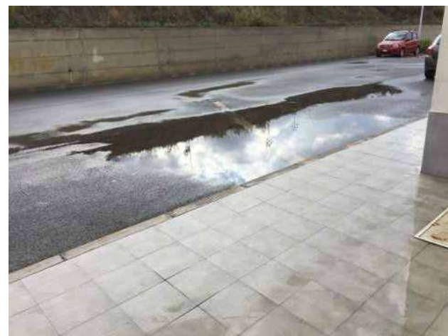
Foto N°40 - Vista ravvicinata del ristagno dell'acqua piovana a ridosso del marciapiede di Foto N°39
