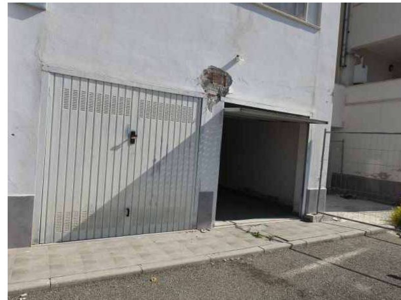
(PV4) Foto N°8 - Ingresso box prop. Masciopinto. Si può notare lo stato di degrado delle pareti murarie e del marciapiede
