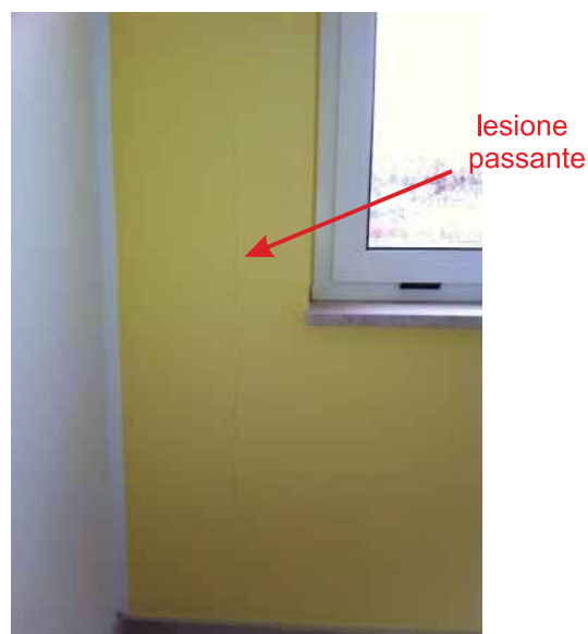
Foto N°43 - Vista ravvicinata della lesione verticale lungo la zona di contatto tra il pilastro e la muratura di tamponamento (vano scala)
