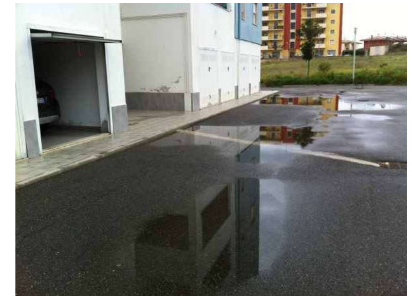
Foto N°39 - Altra vista del ristagno delle acque superficiali lungo il marciapiedi in corrispondenza dell'ingresso al box di proprietà del sig. Masciopinto
