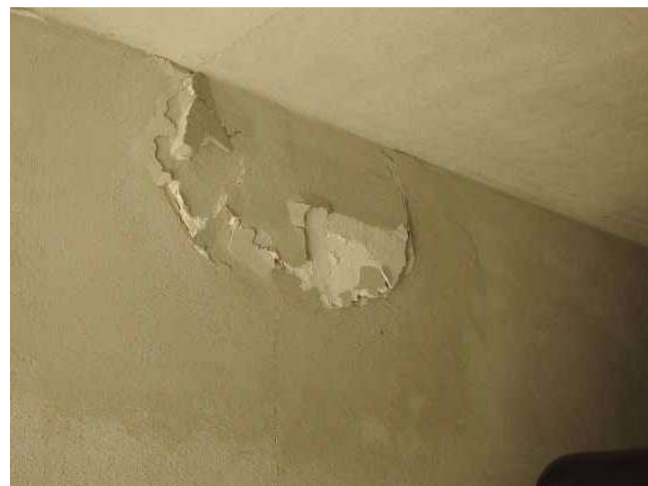
(PV10) Foto N°19 - Interno box di foto N°18. Sulla divisione muraria, in alto, si rileva una evidente frattura
