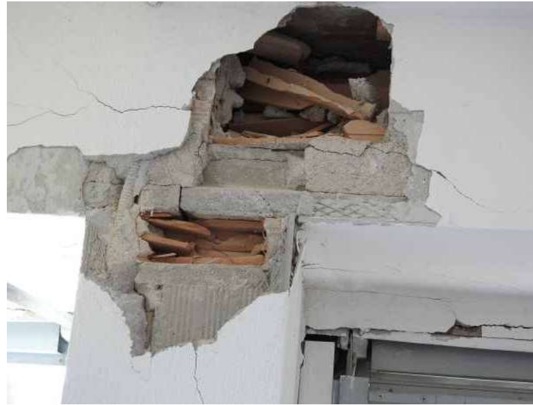
(Pv6) Foto N°11 - Particolare delle lesioni di Foto N°10 nel punto in cui è presente la frantumazione della muratura
