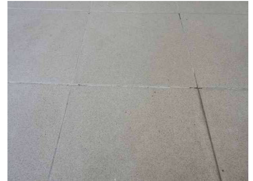
(PV6) Foto N°12 - Particolare della disconnessione tra le piastrelle del pavimento del box di cui alla foto N°10 e 11
