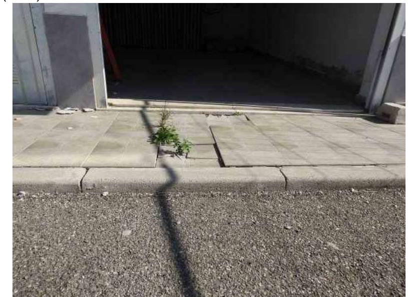
(PV5) Foto N°9 - Particolare marciapiedi della foto N°8. Si rileva lo sprofondamento della pavimentazione e l'incomplanarità rispetto alla soglia dell'ingresso.
