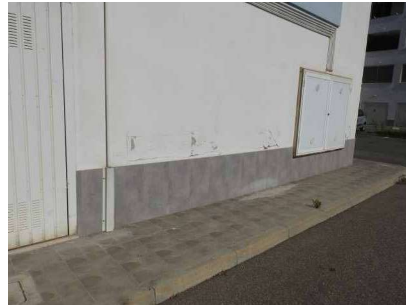
(PV3) Foto N°5 - Particolare degrado e lesioni dell'intonaco
