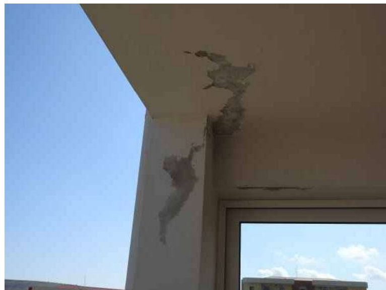
Foto N°34 - Particolare del degrado sul soffitto e sui pilastri della veranda dell'appartemeneto di prop. del sig. Masciopinto
