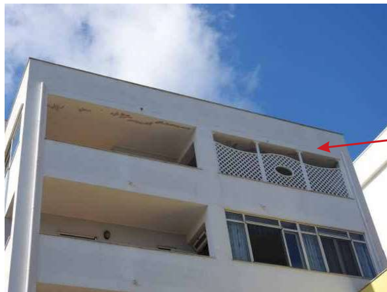
(PV18) Foto N°31 - Soffitto della veranda dell'appartamento prop. Masciopinto. Si può notare la presenza di umidità e di una lesione orizzontale di distacco ricorrente su tutta la veletta in corrispondenza del punto di contatto con il solaio
