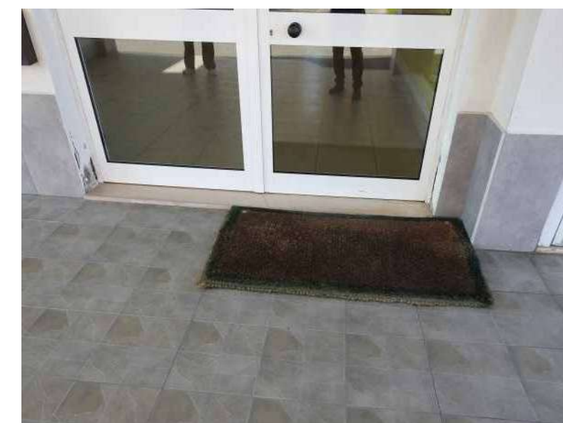
(PV13) Foto N°24 - Ingresso principale del fabbricato (degrado delle mazzette delimitanti la porta)
