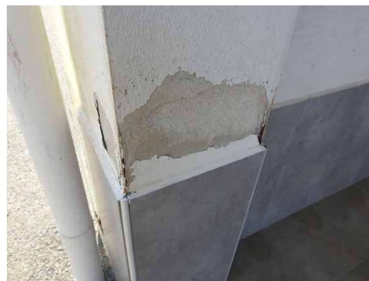
(PV12) Foto N°23 - Particolare del degrado ritratto dalla nella foto N°22
