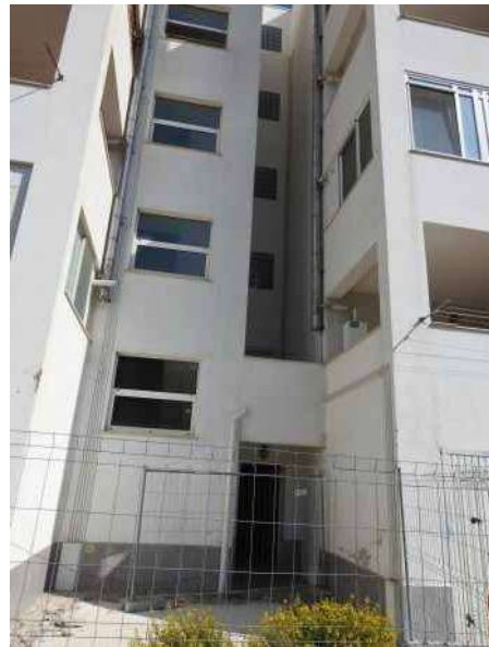
Foto N°13 - Zona del fabbricato ove è stato rimosso il preesistente serbatoio (fronte lato monte)
