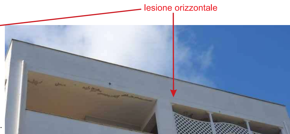
Foto N°32 - Particolare del degrado e della lesione di Foto N°31
