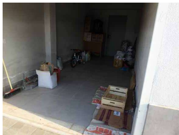
(Pv8) Foto N°16 - Degrado nelle parti basse della muratura del box di Foto N°15
