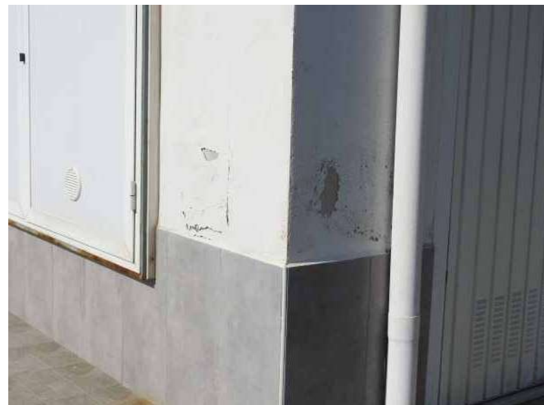
(PV2) Foto N°7 - Particolare degrado dell'intonaco
