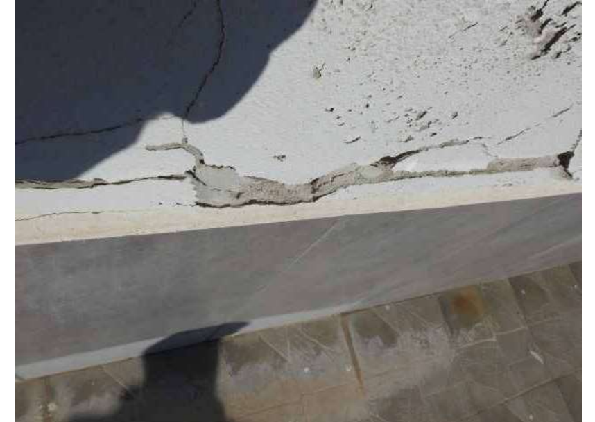
(PV3) Foto N°6 - Vista ravvicinata delle lesioni in foto N°5
