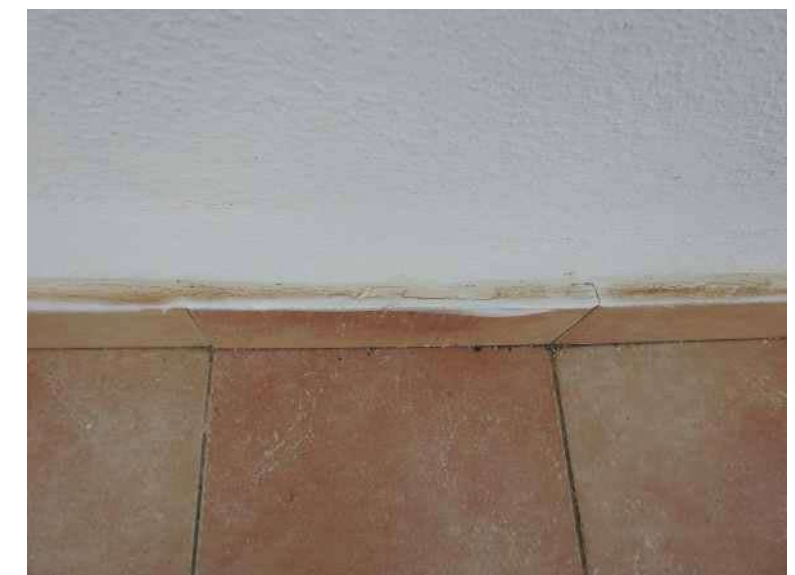
Foto N°36 - Vista dettagliata dei segni di distacco del battiscopa lungo il parapetto di Foto N°35 di entità, allo stato, ancora capillare
