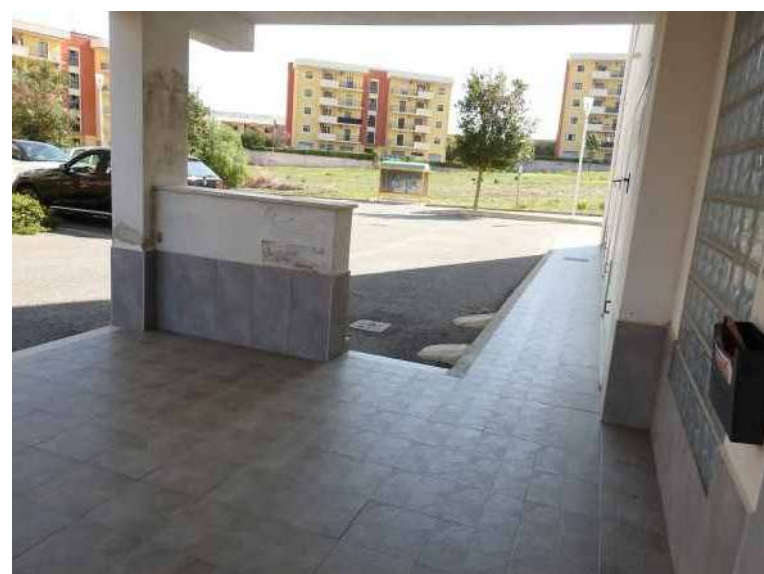
(PV12) Foto N°22 - Ingresso fabbricato con evidenti segni di degrado a carico dell'intonaco delle murature
