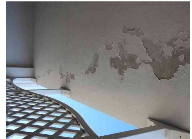
Foto N°33 - Particolare del degrado sul soffitto della veranda dell'appartamento del sig. Masciopinto (quarto piano)
