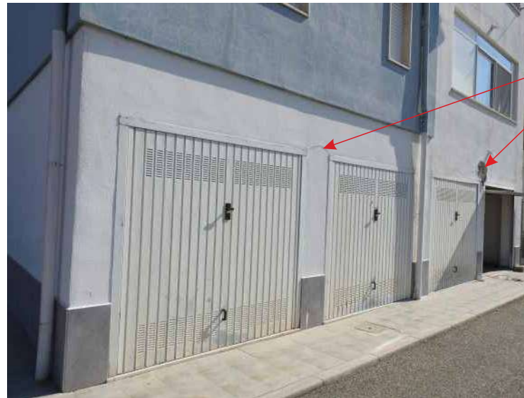
(PV7) Foto N°14 - Vista ampliata degli accessi ai box di cui alla foto N°8. Si può notare la lesione ad arco sulla muratura indicativa di un cedimento, al pari di quanto avvenuto nella muratura del box adiacente
