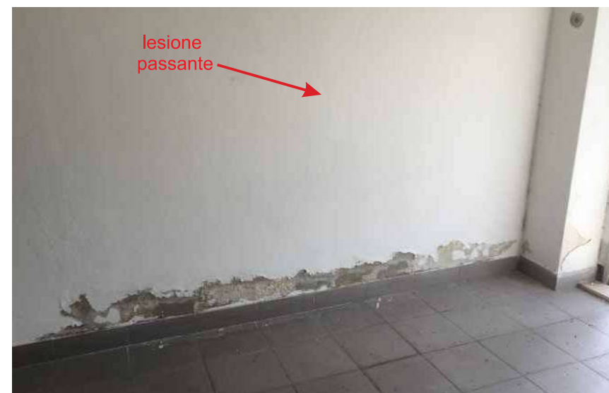
Foto N°44 - Vista del degrado dell'intonaco per umidità da risalita nelle parti basse della muratura del box di prop. del sig. Masciopinto e della lesione passante lungo il muro esterno (lato dx ingresso box)
