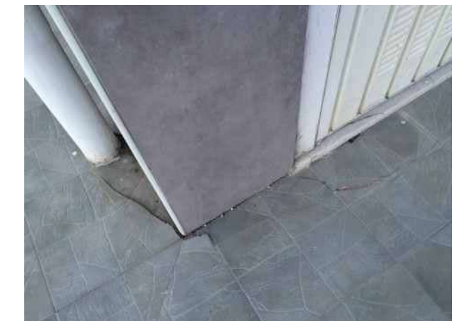
Foto N°47 - Sprofondamento della pavimentazione del marciapiedi in corrispondenza dell'angolo Sud-Ovest (fronte lato monte) del fabbricato
