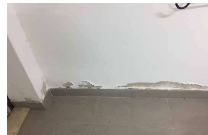
Foto N°45 - Degrado dell'intonaco nella parte bassa della muratura opposta a quella della Foto n°44, nel del box di proprietà del sig. Masciopinto
