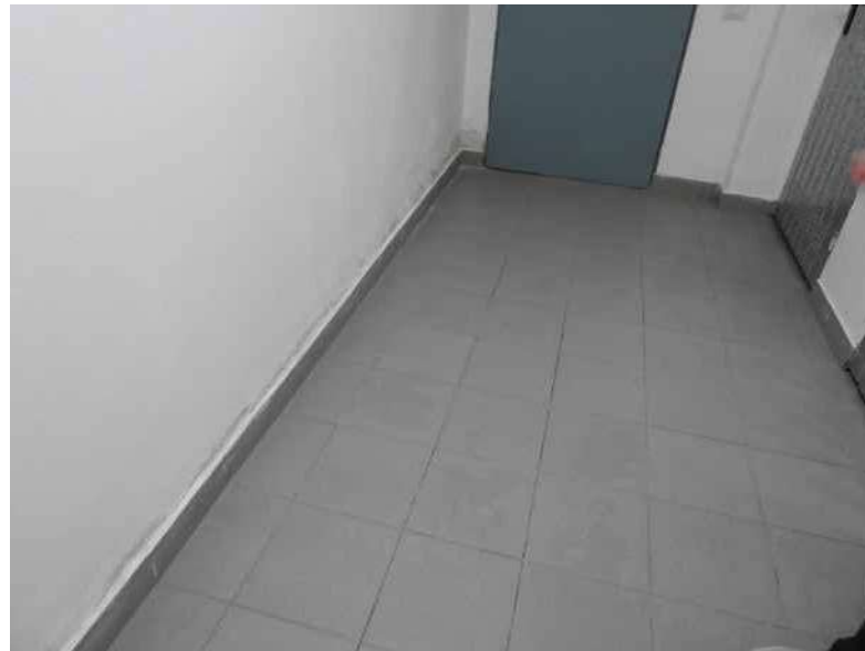
(PV16) Foto N°28 - Corridoio reparto cantine. Si noti il degrado dell'intonaco nelle parti basse della murature
