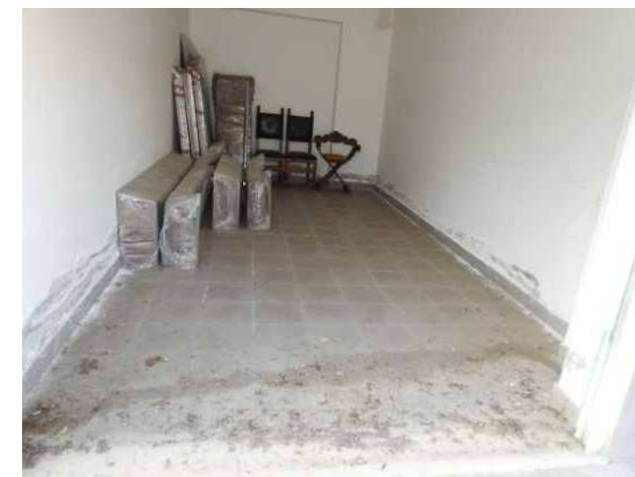
(Pv11) Foto N°21 - box prop. Lumare: si può rilevare il degrado dell'intonaco nelle parti basse della muratura interna
