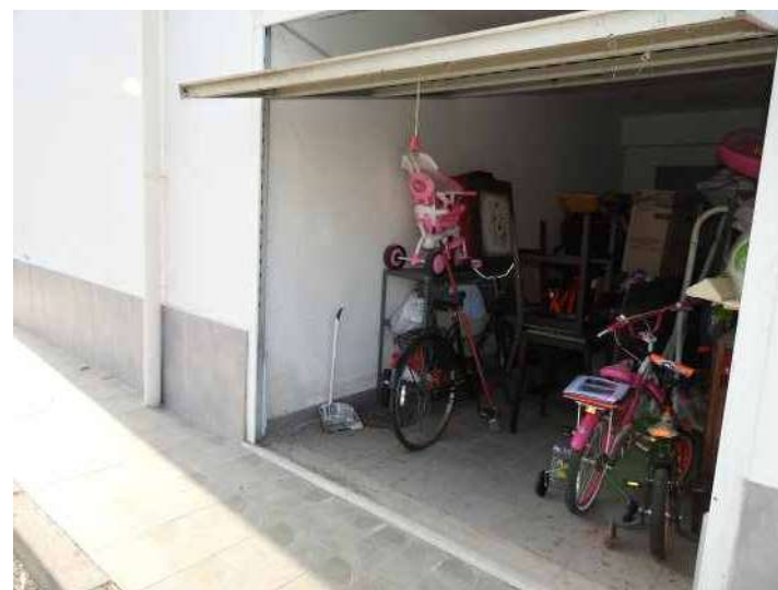
(PV11) Foto N°20 - Ingresso box prop. Rota: si può notare il degrado dell'intonaco nelle parti basse della muratura interna
