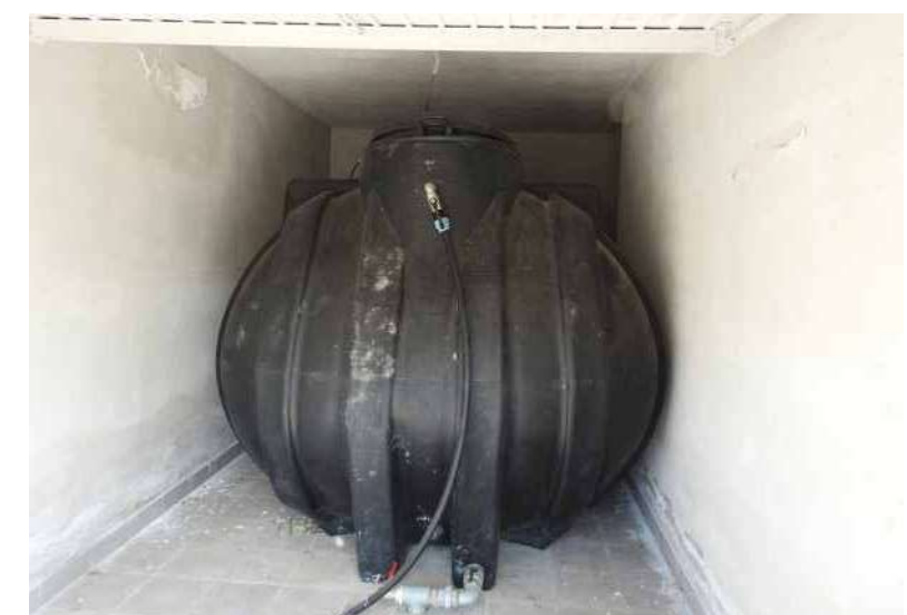
(PV10) Foto N°18 - Vista del box in cui è allocato il serbatoio idrico. Si può notare il degrado nelle parti basse della muratura
