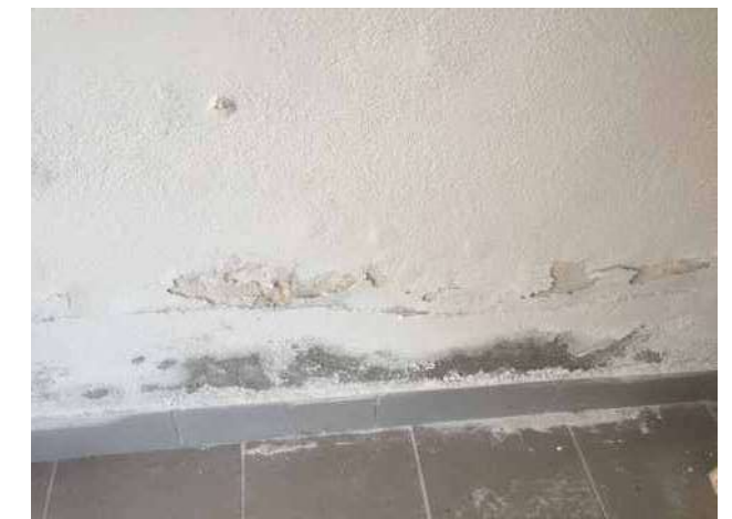
Foto N°46 - Ammaloramento dell'intonaco per umidità da risalita lungo la parte inferiore delle pareti interne del box di proprietà del sig. Carlosecchi
