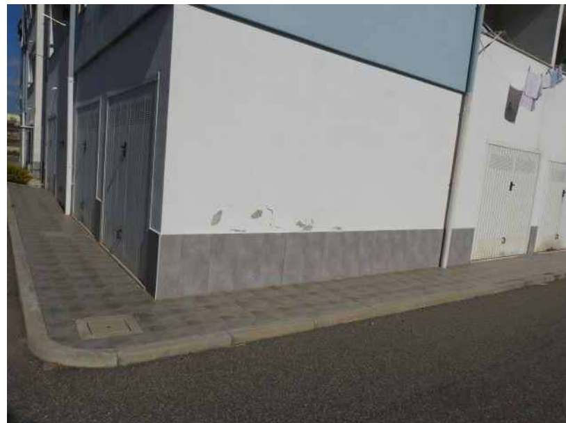
(PV1) Foto N°4 - Particolare degrado dell'intonaco (angolo S-E)
