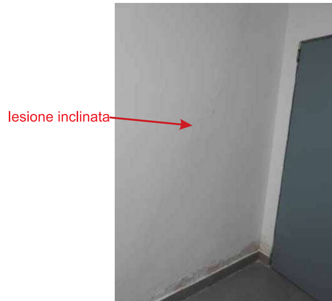
(PV16) Foto N°29 - Particolare della lesione passante lungo la parete divisoria posta tra il corridoio delle cantine ed il box di proprietà del sig. Masciopinto
