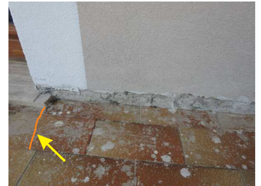
Foto N°25 - Particolare della lesione 2 con vista dell'assenza della rasatura della parete lungo la linea di contatto con il pavimento
