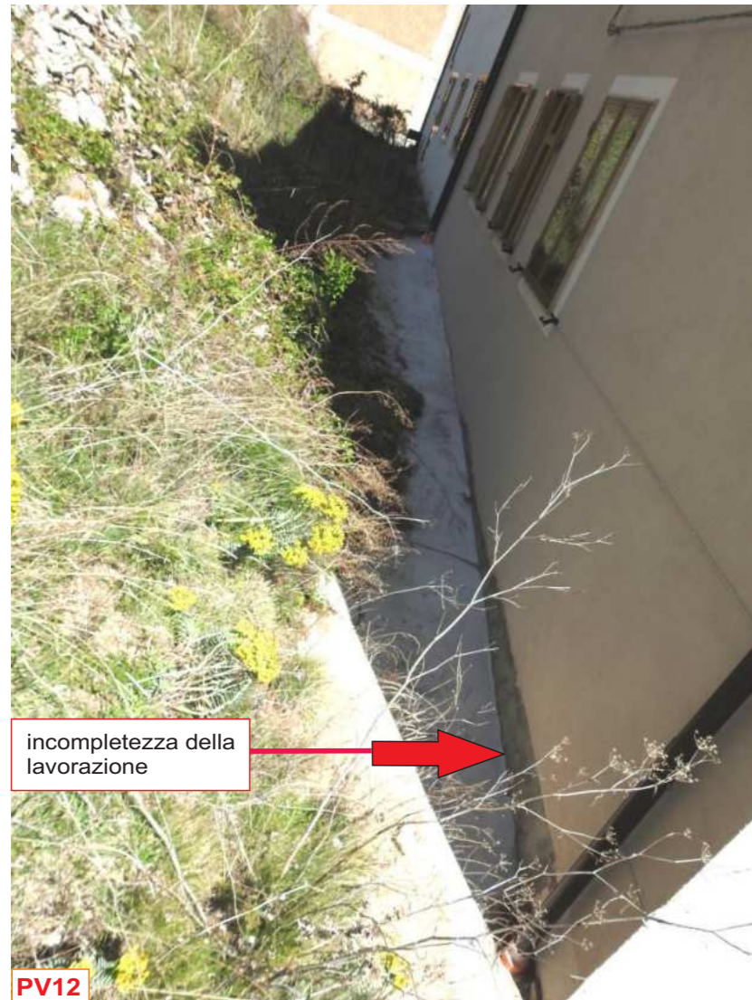
Foto N°40- Fronte posteriore (lato ovest): si evince l'incompletezza della lavorazione nella zona di contatto con lo strato di fondo in materiale cementizio
