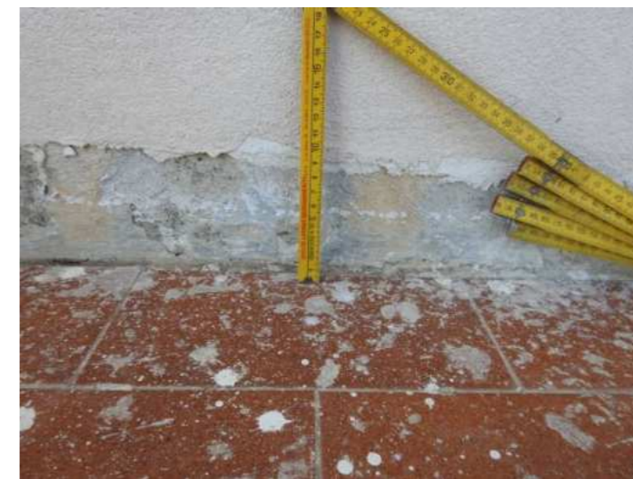
Foto N°17 - L'applicazione della rasatura si ferma a circa 10 cm dal pavimento del balcone, condizione da cui si presume la successiva applicazione dei battiscopa
