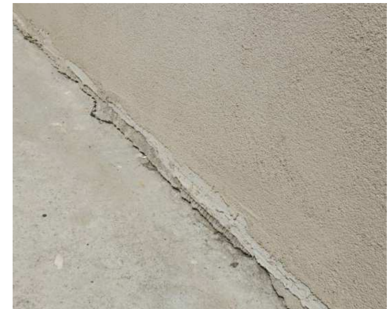
Foto N°39 - Particolare della lavorazione eseguita lungo la linea di contatto tra la parete ed il marciapiedi di cui alle Foto N°37 e 38 (condizione non oggetto di contestazione nell'atto di citazione)
