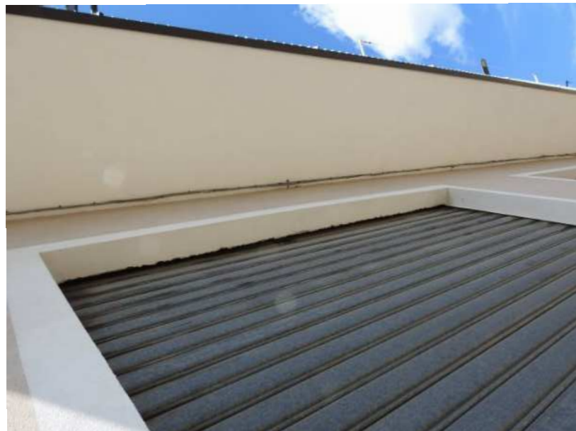
Foto N°34 - Architrave apertura di accesso al garage con presenza di irregolarità di finitura dello spigolo interno
