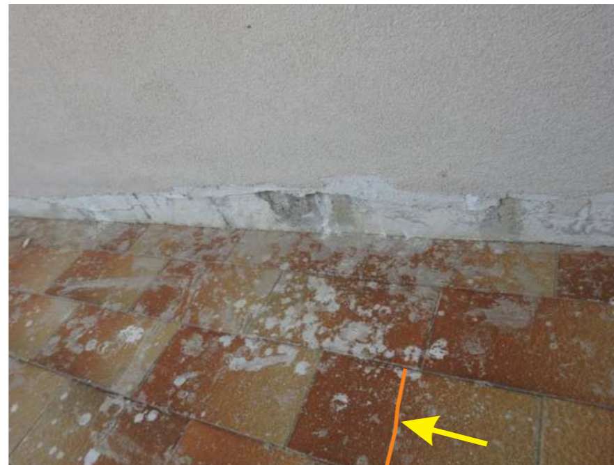
Foto N°26 - Particolare della lesione 3 e dell'incompletezza della rasatura della parete lungo la linea di contatto con il pavimento. Si tratta di una condizione che, evidentemente, implica la successiva posa dei battiscopa
