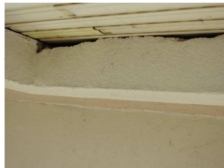
Foto N°20 - Particolare della marcata irregolarità dello spigolo dell'architrave di cui alla Foto N°19
