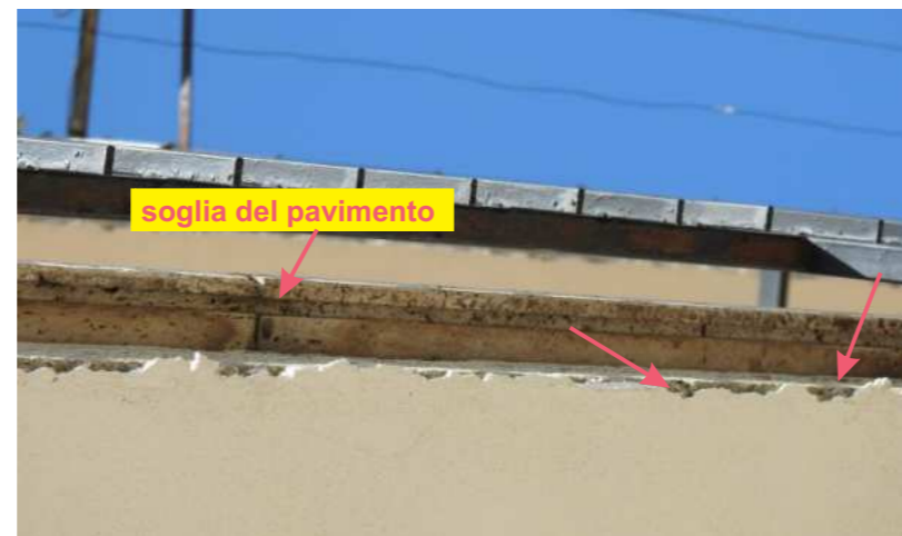
Foto N°29 - Vista dal basso del frontale del balcone, privo di finitura e/o rivestimento
