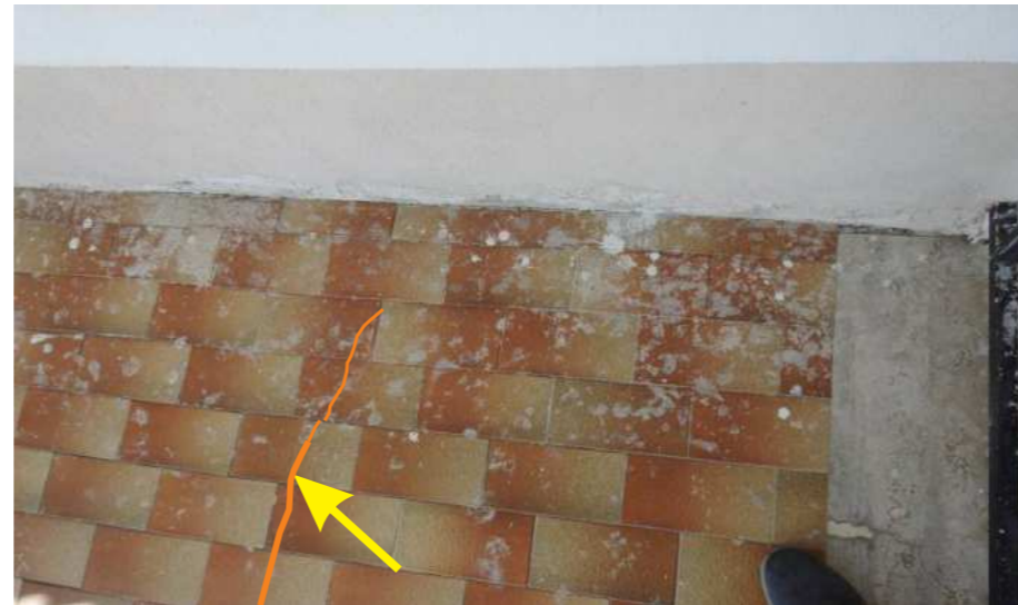
Foto N°24 - Particolare della lesione 1
