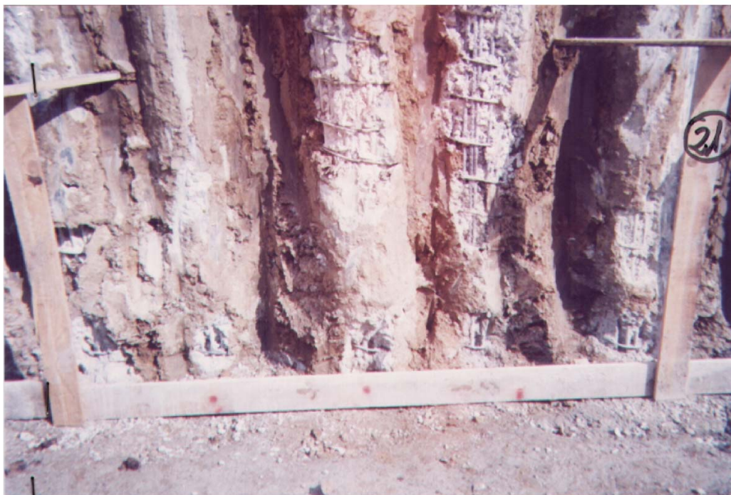
FOTO N°21AT: Vista del piano di imposta del muro di altezza cm 120. Si conferma quanto dedotto nel commento della foto N°10AT
