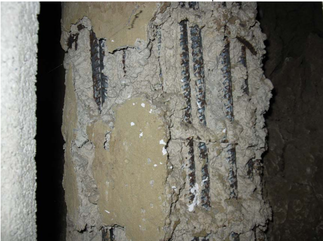
P.V.10– FOTO N°16: Palo ripreso attraverso l'apertura esistente nella muratura (locale tecnico) Si conferma il commento di cui alla precedente foto
