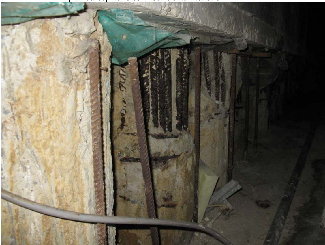
P.V.6– FOTO N°7: Estremità superiore di alcuni pali. Si nota la disomogeneità del calcestruzzo, l'irregolarità strutturale del palo, l'avanzata corrosione dei ferri di armatura privi del copriferro ed l'insufficiente interferro
