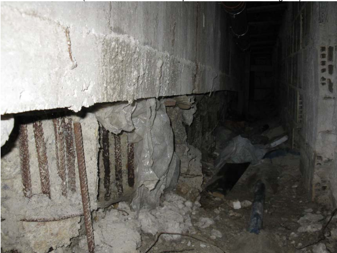
P.V.9– FOTO N°14: Vista ravvicinata dell'estremità superiore dei pali (commento riconducibile a quello della successiva fotografia)
