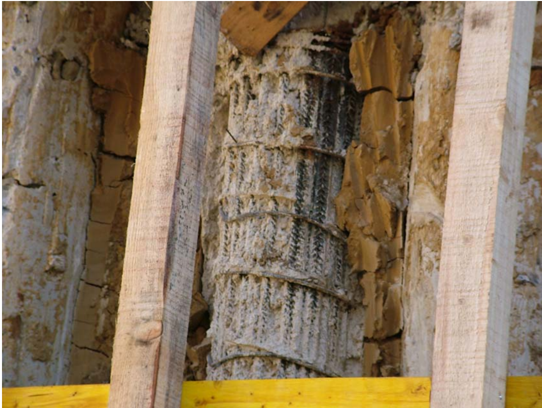
FOTO N°3AC: Aspetto tipico di alcuni pali: si nota l'assenza di copriferro e l'insufficiente interferro
