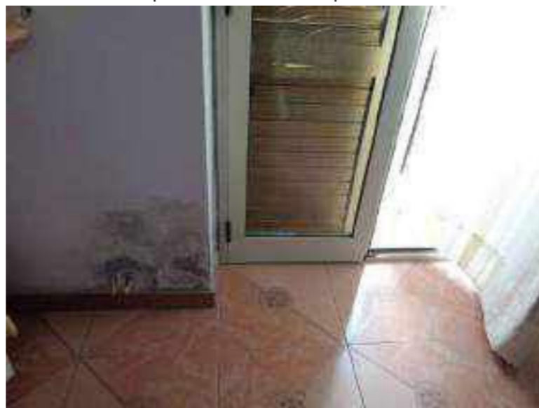
Foto 3F - Camera da letto con segni di umidità nella parte inferiore della parete esterna
