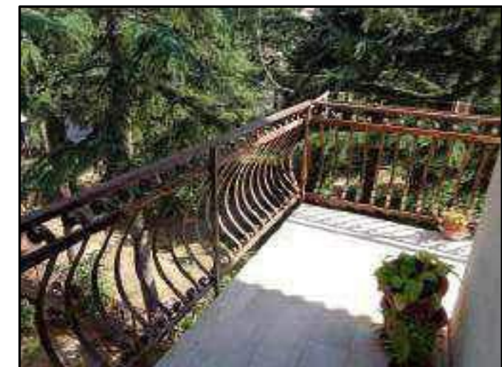
Foto 4D - Vista del balcone e della ringhiera
