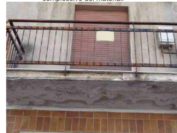
Foto 11C - Vista ravvicinata del balcone adiacente il vano scala: si può notare il degrado complessivo dei materiali
