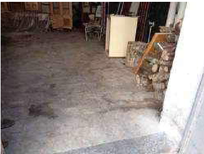
Foto 2D - Particolare del degrado del pavimento nei pressi dell'ingresso al n°civ. 123
