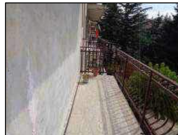
Foto 5E - Degrado ricorrente a carico dell'intonaco esterno. La foto si riferisce al balcone lungo il fronte nord
