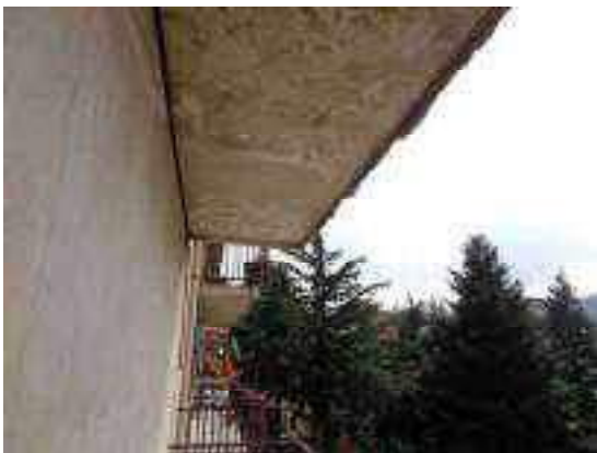
Foto 7M – Vista dello stato di degrado del balcone di piano, lato sud
