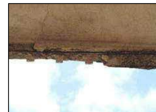
Foto 5F - Il balcone, visto dal piano sottostante, è rappresentativo dello stato di avanzato degrado in cui versano anche i restanti oggetti
