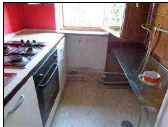
Foto 6C - Il cucinino con tubazione a vista di gas, acqua e dello scarico in condizioni di precaria sicurezza
