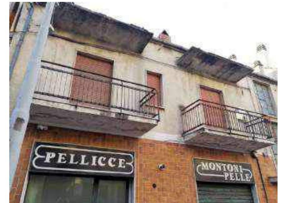
Foto N°12 - Vista ravvicinata della Foto N°2 dalla quale si può notare lo stato di degrado dei balconi e delle soprastanti pensiline (v. descrizione in Scheda N°11)
