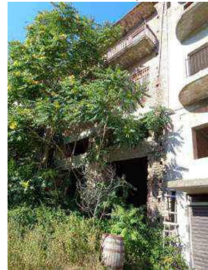
Foto N°15 - Vista del fronte ovest del fabbricato, opposto a quello principale di Foto N°2 (confr. descrizione in Scheda N°9 e 11)
