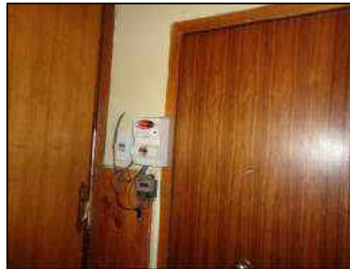
Foto 6A - Il portoncino d'ingresso con a fianco il contatore Enel, non protetto
