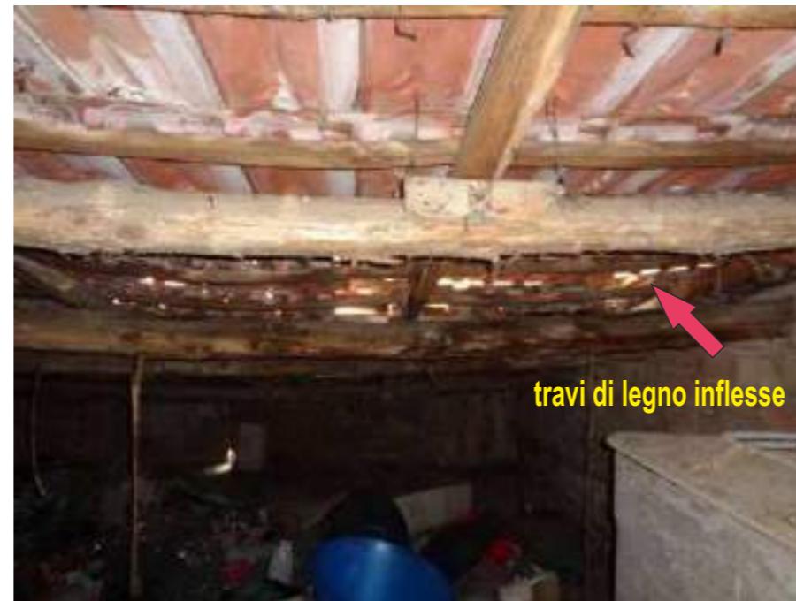
Foto 11M - Alta vista ravvicinata rappresentativa dello stato di criticità statica in cui versa la copertura
