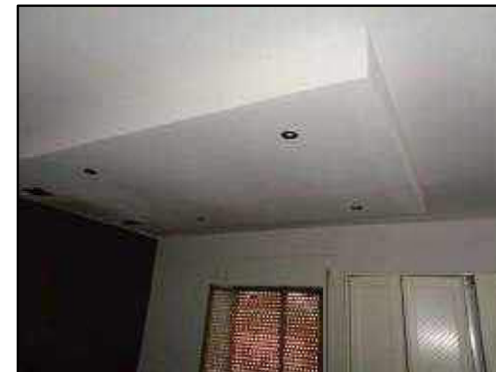
Foto 6F - La controsoffittatura nella camera da letto con segni di umidità
