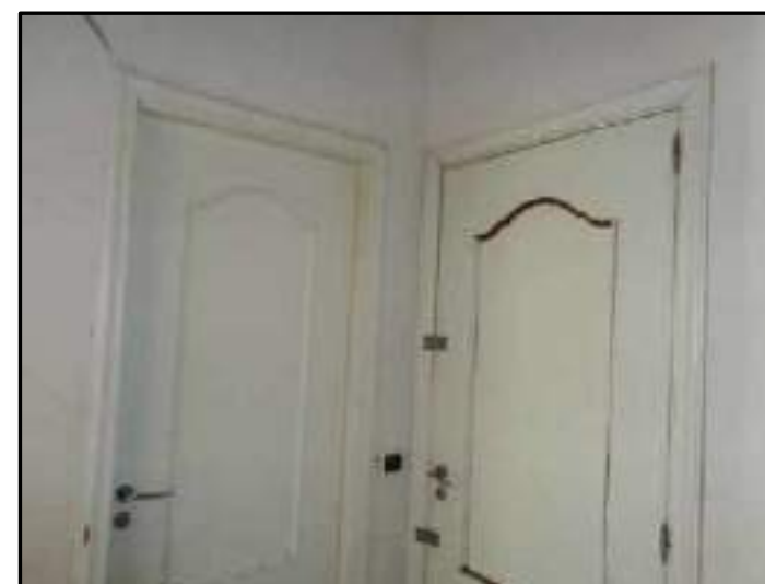
Foto 6E - Lo stato delle porte interne nella zona notte
