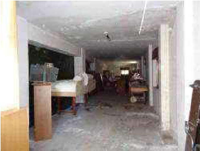
Foto 2B - Interno ripreso dall'accesso n°civ. 125 (degrado del soffitto e del pavimento per umidità da infiltrazioni)
