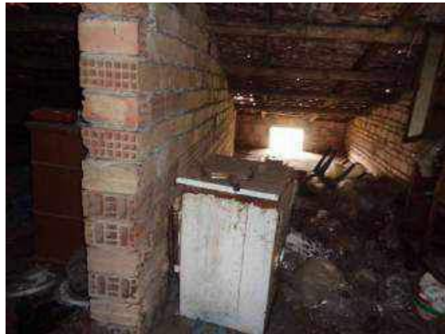
Foto 11O - Il muro di spina in corrispondenza del punto in cui si accede alla soffitta
