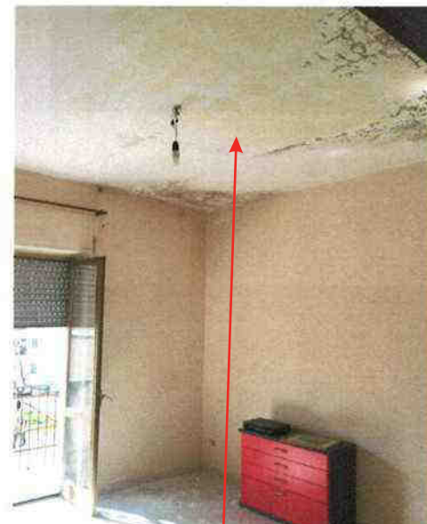
Foto N°24: Il soffitto della stanza 3 come risulta dalla foto della CTP di parte attrice, ripreso in data 08.03.2017
