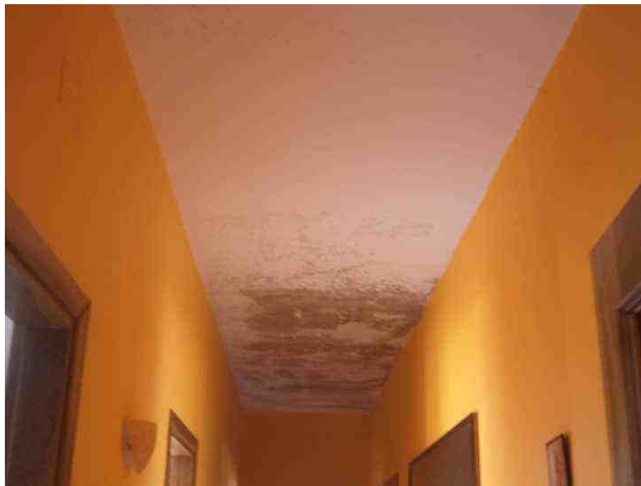
Foto N°12 (CTU in ATP) - PV6 Copiose macchie di umidità lungo il disimpegno dell'immobile
