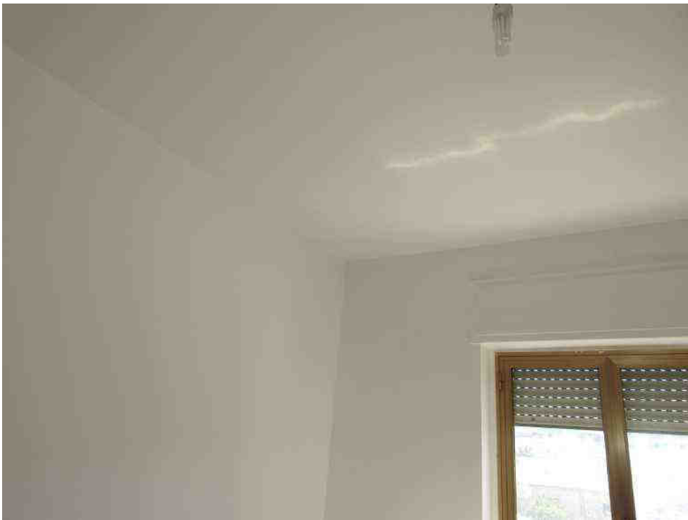
Foto N°14 - PV7: Pareti d'angolo della stanza 4 a cui si riferisce la foto N°21 del CTU in ATP
