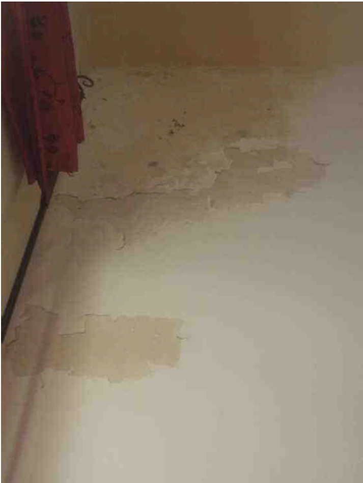
Foto N°21 (CTU in ATP) - PV14 Distacchi di vernice e copiose macchie di umidità riscontrate sulle pareti verticali
