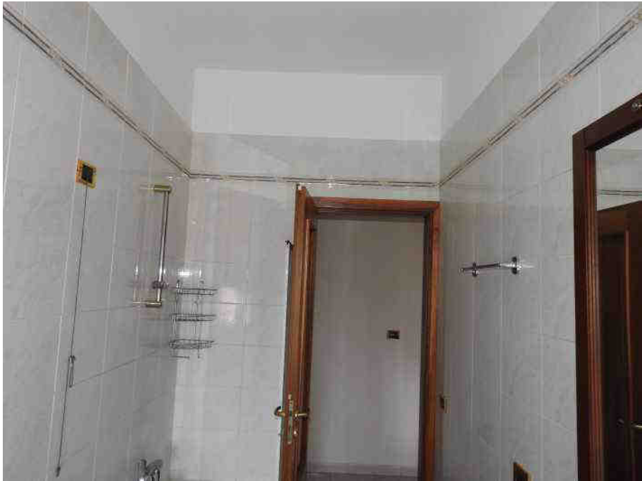
Foto N°10 - PV18: Vista bagno (pareti interne e soffitto)
