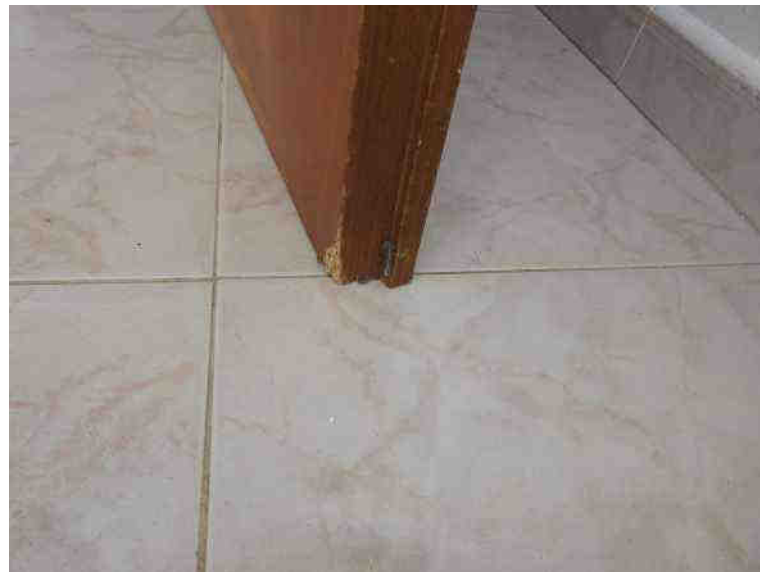
Foto N°17: Rigonfiamento spigolo inferiore (stanza 5)
