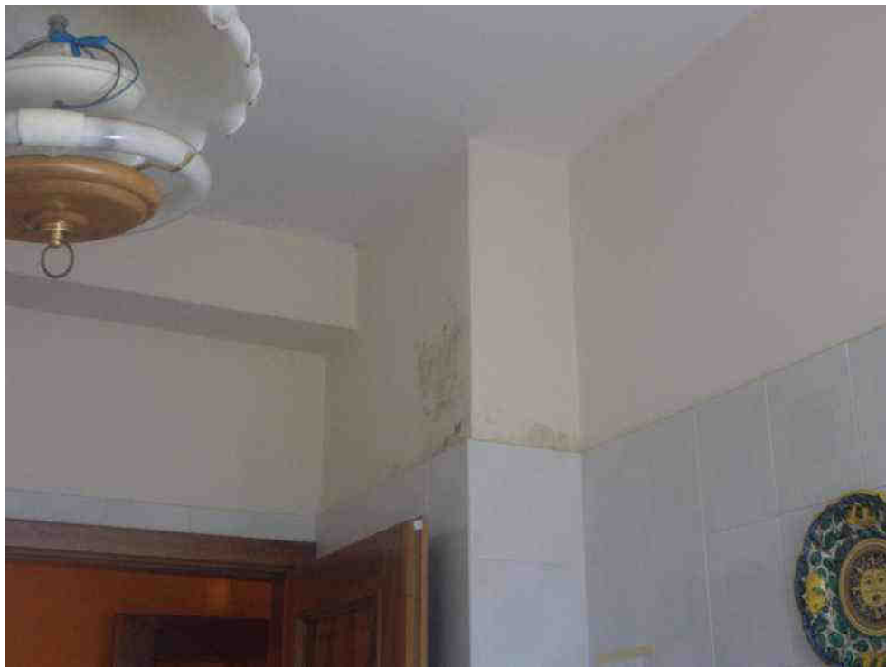
Foto N°10 (CTU in ATP) - PV8 Macchie di umidità rilevate nel locale cucina
