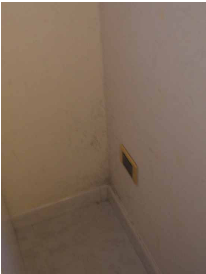
Foto N°23 (CTU in ATP) - PV16 Presenza di muffa nelle zone d'angolo in basso (probabile mancanza di aerazione del locale)
