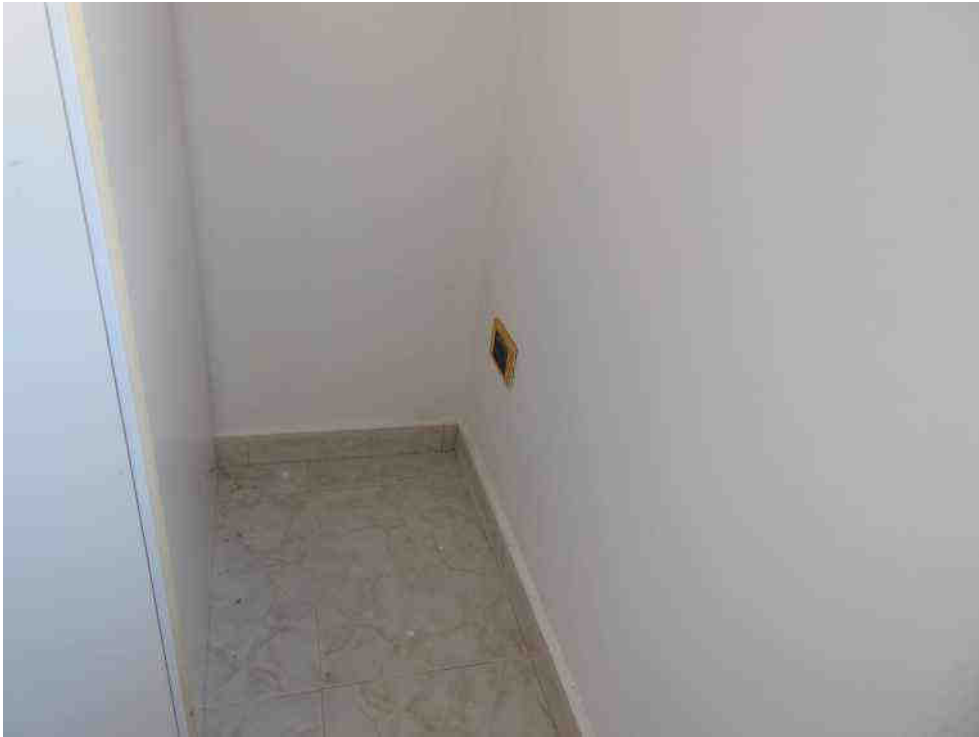
Foto N°8 - PV16: Altra vista stanza 6 (parte inferiore muri d'angolo N-O)
