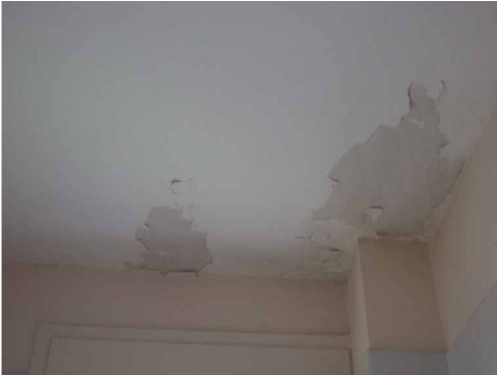
Foto N°27 (CTU in ATP) - PV19 Ulteriori distacchi di vernice riscontrati nel locale cucina N. B. . si tratta della parete nord del bagno e non della cucina
