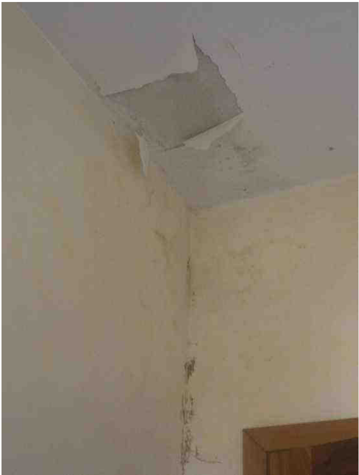
Foto N°24 (CTU in ATP) - PV17 Evidenti distacchi di vernice a causa della eccessiva presenza di umidità
