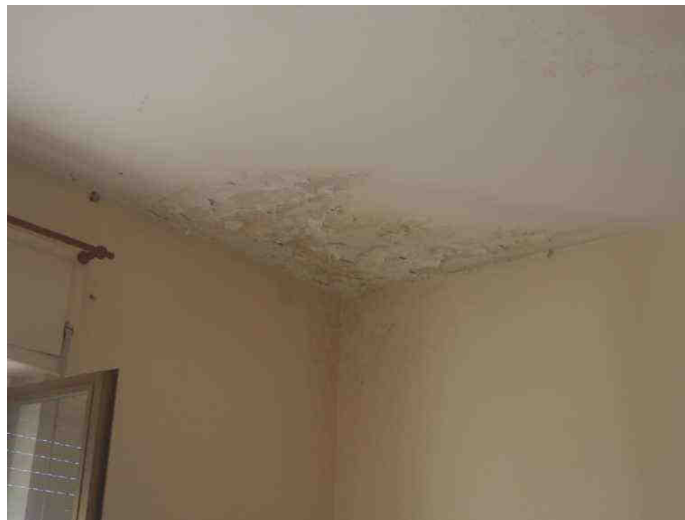
Foto N°15 (CTU in ATP) - PV10 Distacco della vernice e di parte dell'intonaco a causa dell'eccessiva umidità
