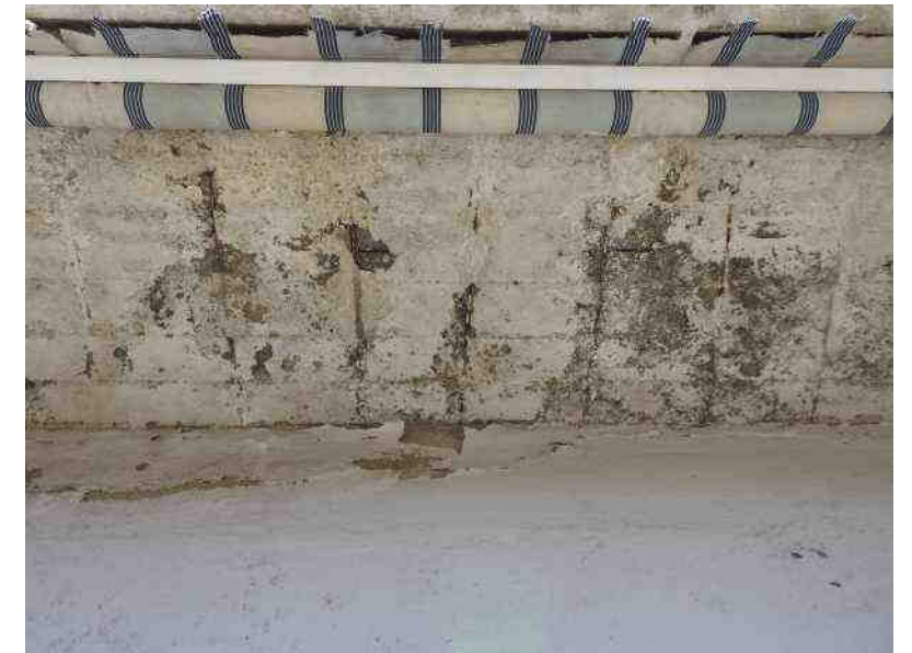
Foto N°22: Intradosso della pensilina soprastante il balcone della stanza n°1
