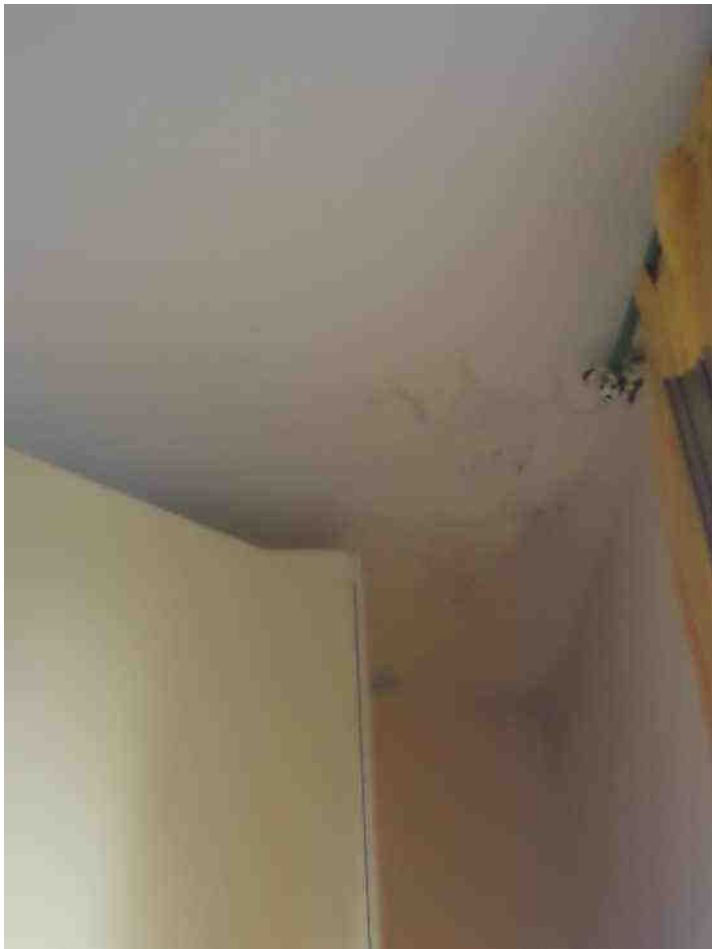
Foto N°22 (CTU in ATP) - PV16 Principio di distacco a causa della presenza di umidità
