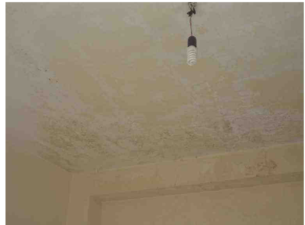
Foto N°16 (CTU in ATP) - PV11 Intradosso del solaio danneggiato dalla probabile infiltrazione di acqua
