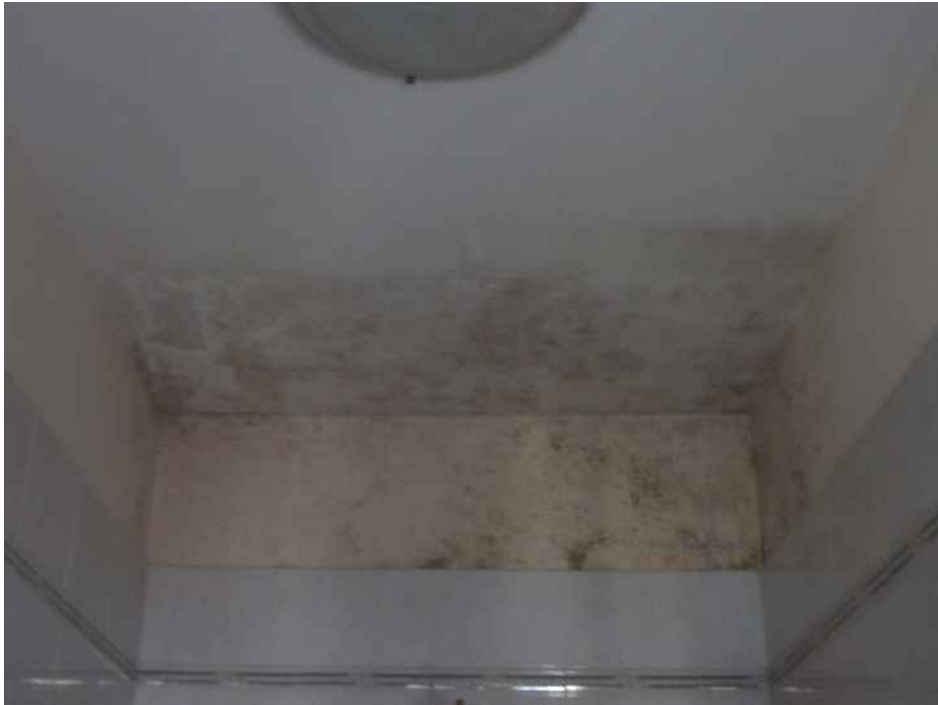
Foto N°25 (CTU in ATP) - PV18 Copiose macchie di umidità presenti nel locale bagno
